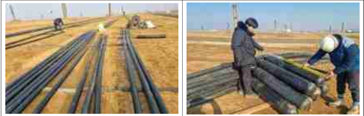
<이송관로 및 응축수 배수장치 준비>
