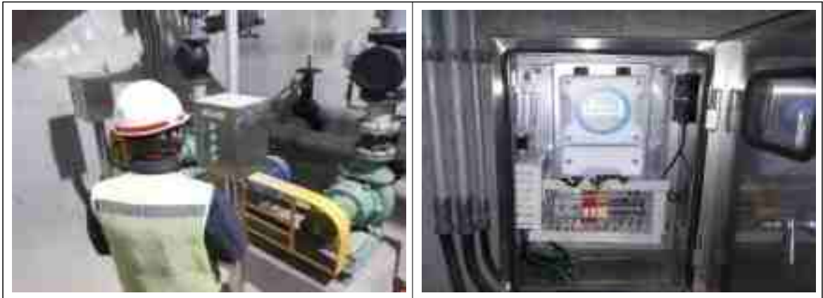
< 침출수 이송펌프 및 유량계 이상유무 확인 >
